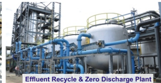
Effluent Recycle & Zero Discharge Plant
