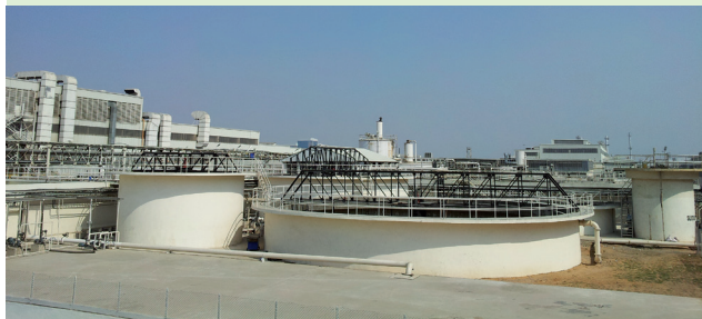
3600 m 3 /d effluent treatment
